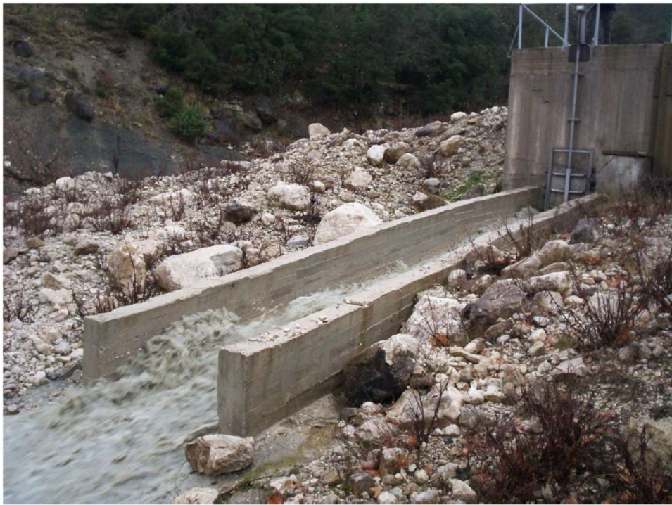
Εικόνα 3.3 Κύρια Υδροληψία ΜΥΗΕ Καταρράκτη (δεξαμενή φόρτισης, φρεάτιο καθαρισμού) (Πηγή: NANKO ΕΝΕΡΓΕΙΑ Ε.Β.Ε.Τ.Ε.)
