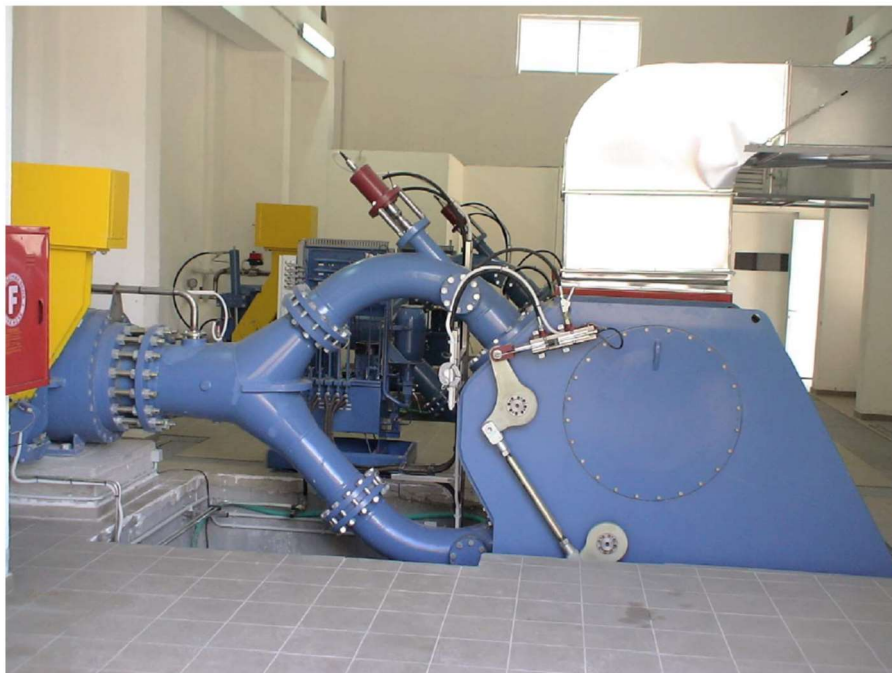
Εικόνα 3.6 Κτήριο ΥΗΣ ΜΥΗΕ Καταρράκτη (εσωτερικό - τουρμπίνα) (Πηγή: NANKO ΕΝΕΡΓΕΙΑ Ε.Β.Ε.Τ.Ε.)
