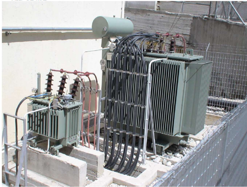
Εικόνα 3.5 Κτήριο ΥΗΣ ΜΥΗΕ Καταρράκτη (μετασχηματιστής) (Πηγή: NANKO ΕΝΕΡΓΕΙΑ Ε.Β.Ε.Τ.Ε.)
