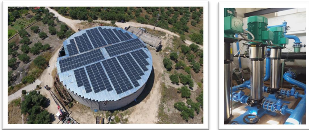
Εικόνα 5-3. Δεξαμενή νερού και αντλιοστάσιο Τζιβαράς Αποκορώνου (από αρχείο Ο.Α.Κ. Α.Ε.)
