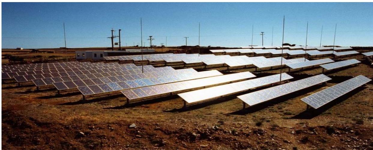
Εικόνα 1.19: Φωτοβολταϊκός Σταθμός Κύθνου της ΔΕΗ Ανανεώσιμες [3]
