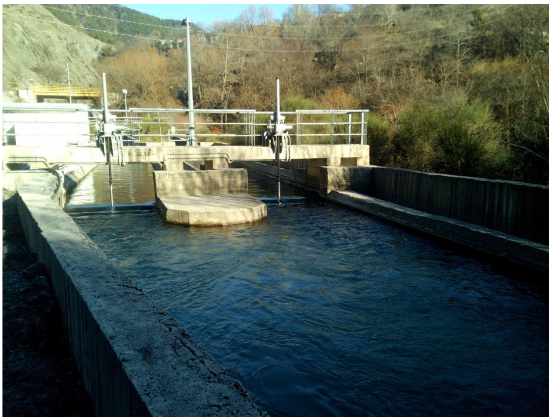
Εικόνα 13: Δεξαμενές καθίζησης φερτών υλικών
