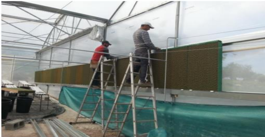
Εικόνα 2.13 : Εγκατάσταση υγρού πάνελ συστήματος ψύξης σε θερμοκήπιο τομάτας.
