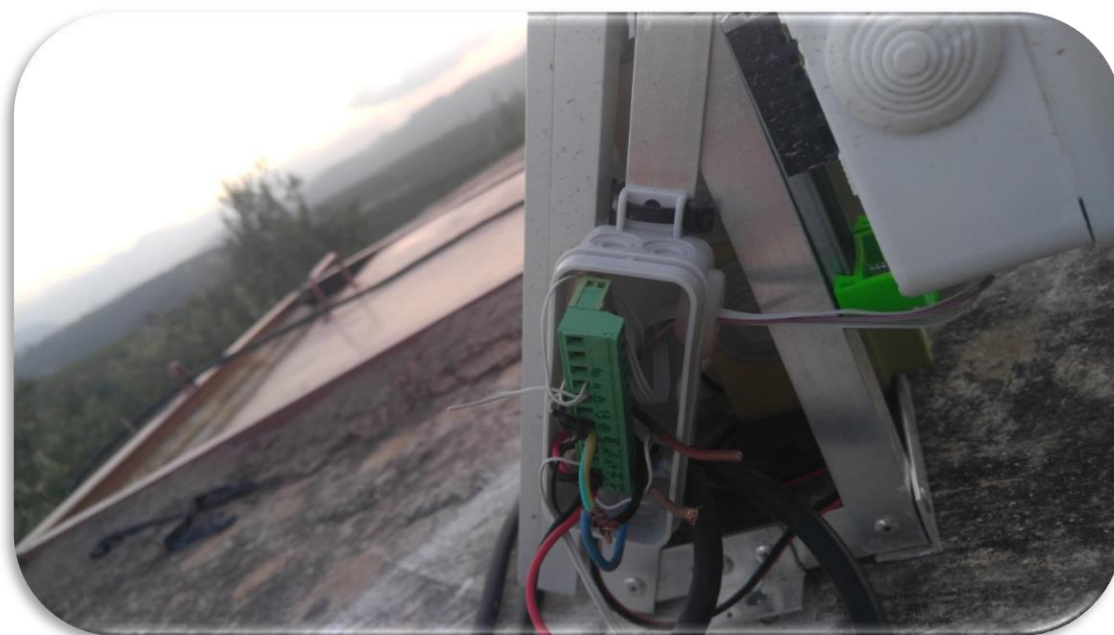
Εικόνα 46 Κατά την εγκατάσταση και σύνδεση των αισθητήρων στάθμης στην δεξαμενή 2
