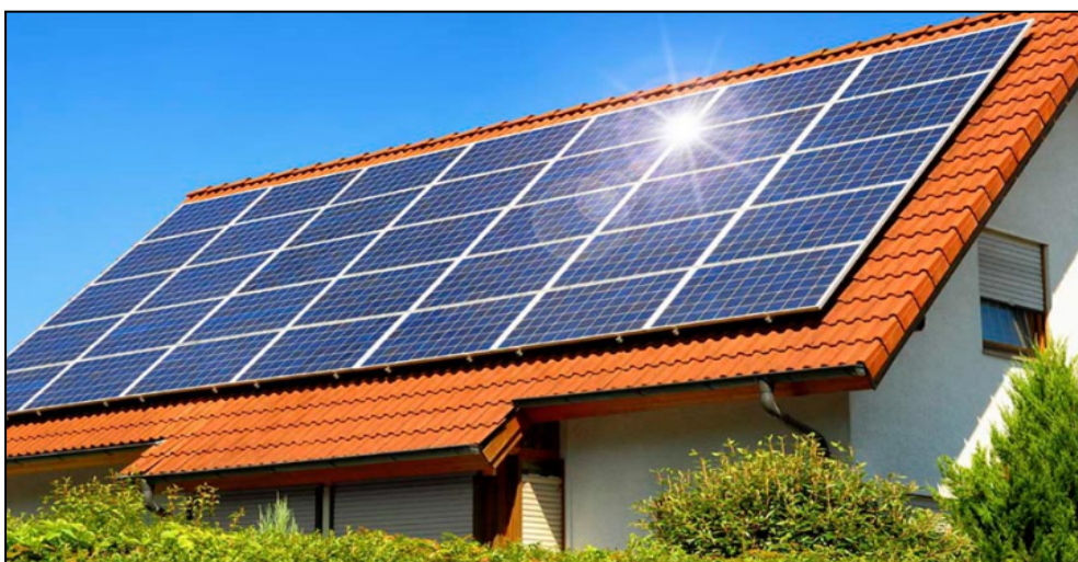
Εικόνα 3.5 (2) : Φ/β σε στέγη
