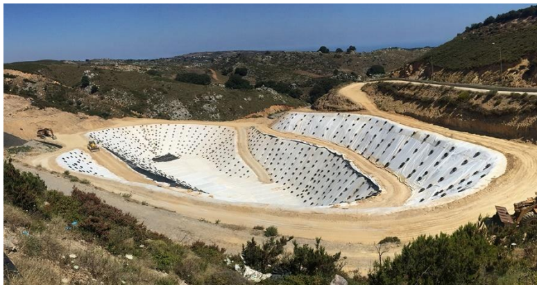
Εικόνα 3.3 : Χώρος υγειονομικής ταφής απορριμμάτων ΧΥΤΑ ή υπολειμμάτων ΧΥΤΥ
