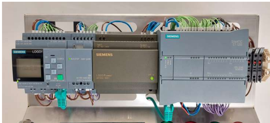
Εικόνα 2.3: Φωτογραφία με τα PLC, τροφοδοτικό και στις ασφαλειοθήκες ράγας.
