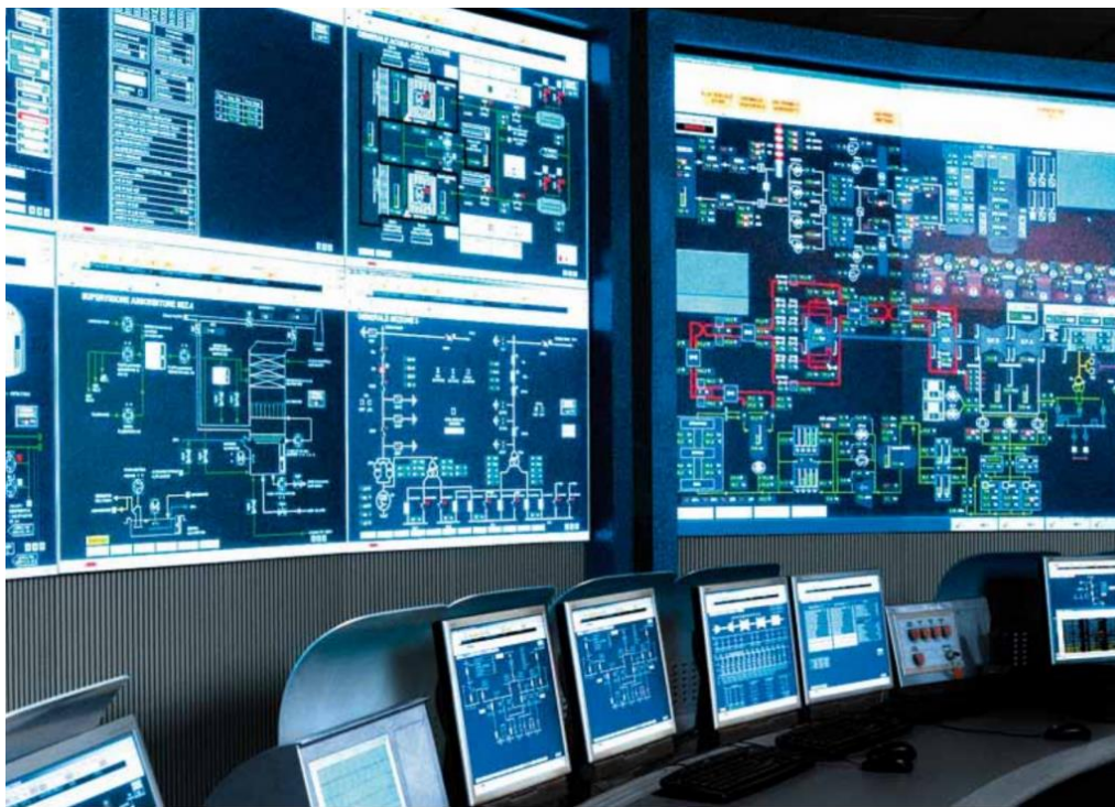
Εικόνα 32 Κεντρικός σταθμός παρακολούθησης SCADA
