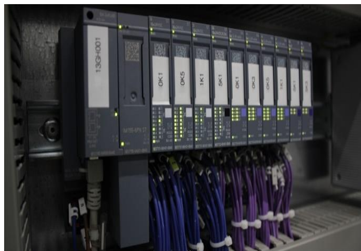
Εικόνα 11 PLC και συστημα I/O
