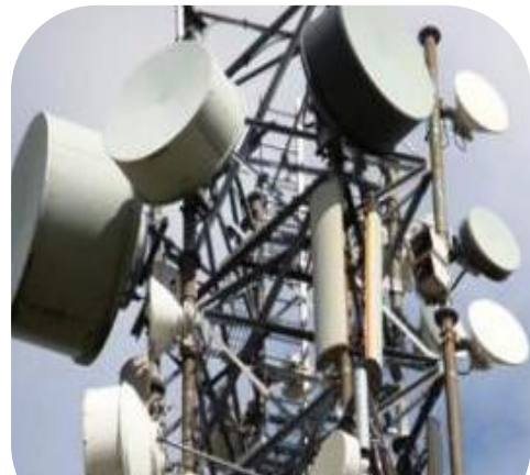
Εικόνα 19 Πύργος ραδιοκυμάτων μικροκυμάτων με κεραιές κινητής τηλεφωνίας
