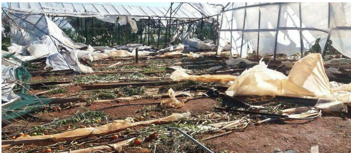
Εικόνα 5.3 Καταστροφή θερμοκηπιακής εγκατάστασης από ανεμοστρόβιλο 2021
