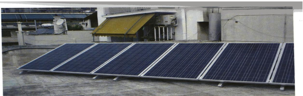
Φωτοβολταϊκή μονάδα επί δώματος κτιρίου.
