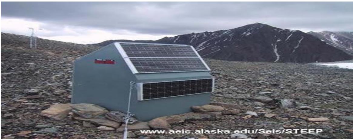
Εικόνα 2-77 Μετεωρολογικός σταθμός στην Αλάσκα με Φ/Β πλαίσια
