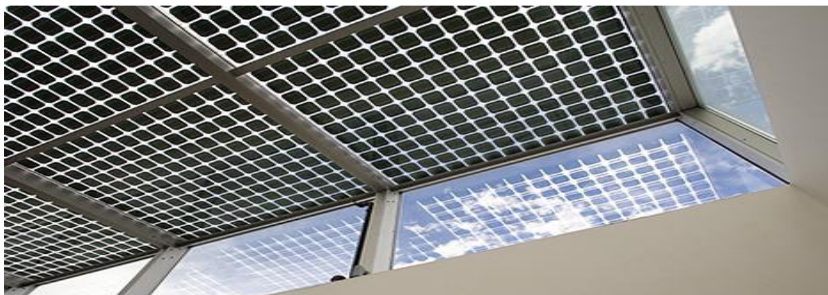
Εικόνα 2-40 Ενσωματωμένα Φ/Β στη στέγη του κτιρίου
