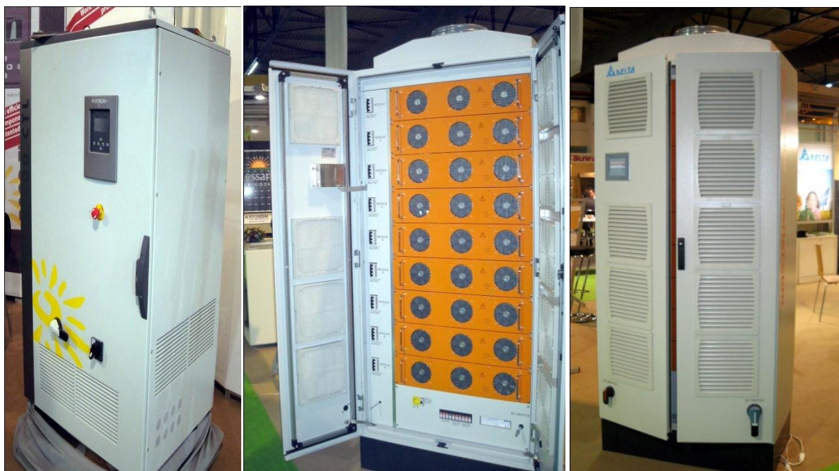
Εικόνα 2-45 Αντιστροφείς (ΕΚΘΕΣΗ ΦΩΤΟΒΟΛΤΑΙΚΩΝ ΜΕΚ ΠΑΙΑΝΙΑΣ, 24-11-09)
