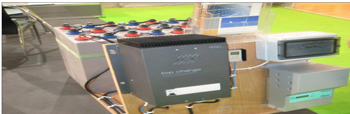
Εικόνα 2-50 Ρυθμιστής φόρτισης (Charge Controller)
