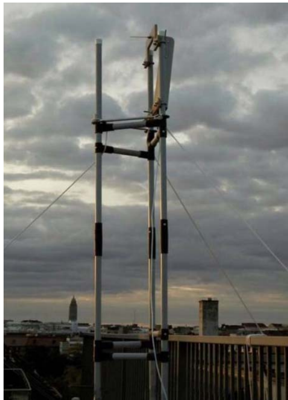
Σχήμα 5.4. Κεραία σταθμού βάσης ( BS_1 ) που είναι τοποθετημένη στη στέγη ενός πολυώροφου χώρου στάθμευσης.
