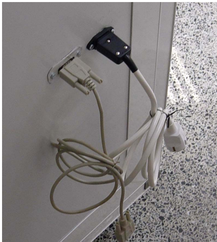
Φωτογραφία 11.1.4.δ Η πλάτη με την RS-232 και την τροφοδοσία του θαλάμου
