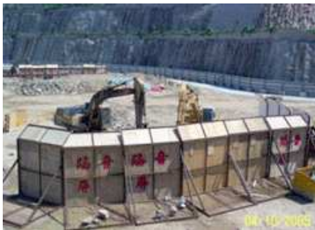
Εικόνα 23. Ηχοπέτασμα από λαμαρίνα στην πηγή
