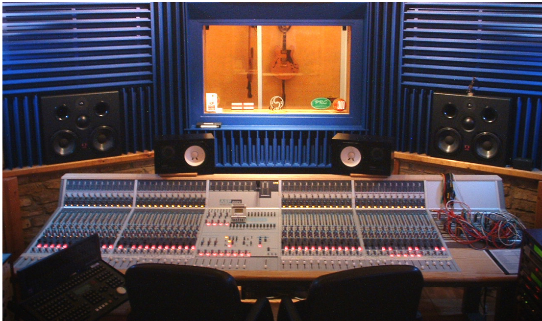
Σχήμα 3 Control Room με προδιαγραφές ESS
