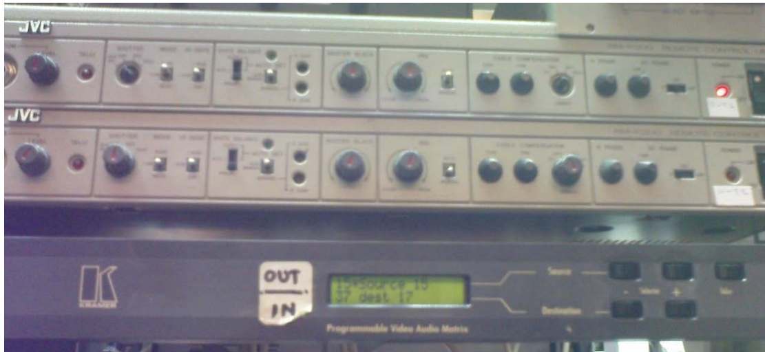
Σχ. 11) Πάνω 2 Remote control για τις 2 σποντιακές κάμερες της JVC κάτω το router της Kramer
