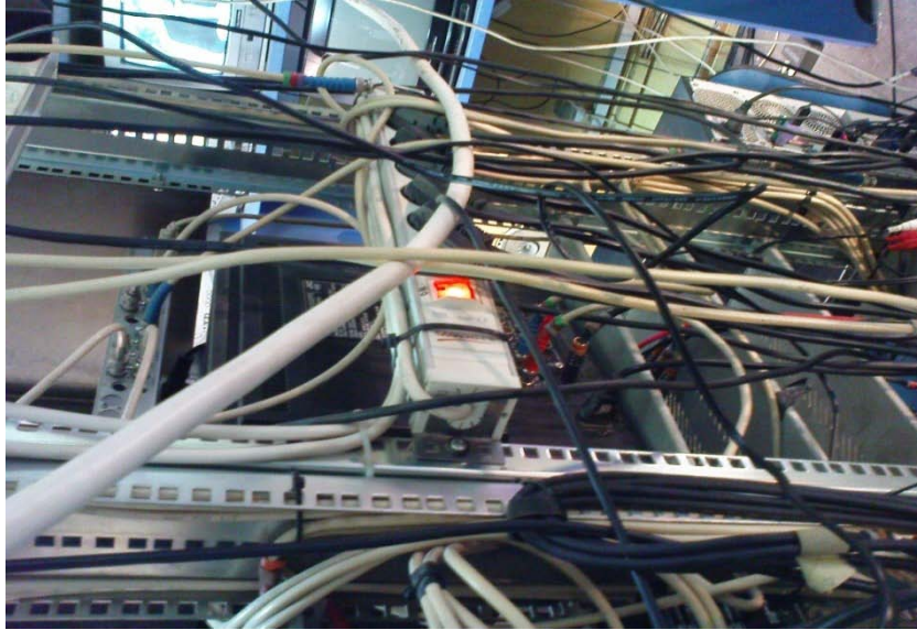
Σχ.9.2) Οι καλωδιώσεις στο control room.
