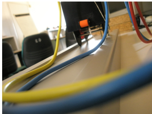
Εικόνα 14 : καλώδια εκτεθειμένα στην πορεία του αμαξιδίου
