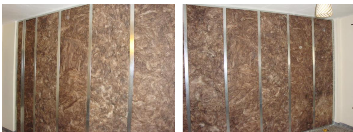
Εικόνα 6. Προσθήκη ορυκτοβάμβακα στο μεταλλικό σκελετό της πλευράς του τοίχου με μήκος 3.67m.
