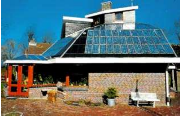
Σχήμα 46 : Φ/Β σε στέγη
