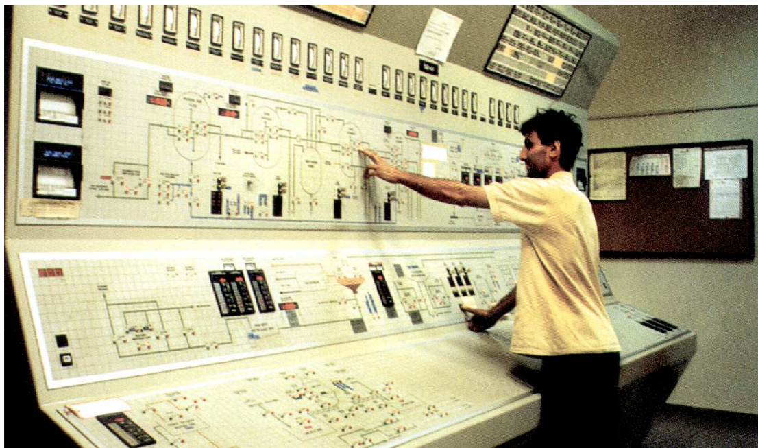
Εικόνα 4.5 Θάλαμος ελέγχου μονάδας (control room) ΑΗΣ Αγ. Δημητρίου [8].
