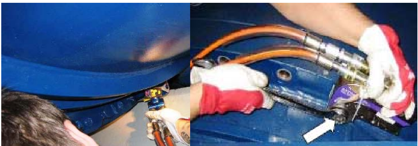
Σχήμα 3.9 Φωτογραφίες κατά την διάρκεια χρήσης του δυναμοκλειδου σε σημεία της ανεμογεννήτριας.
