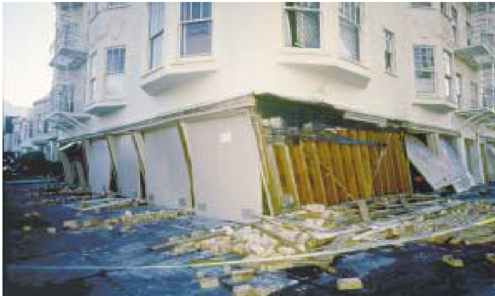
Σχ 2.18 ζημιές σεισμού στο κτίριο του Σαν Φρανσίσκο το 1989 με μέγεθος σεισμού 6.9
