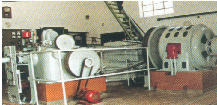
Σχήμα 10.5. Μικρό Υδροηλεκτρικό της ΔΕΗ (Γεωργιούπολη Ν. Χανίων)
