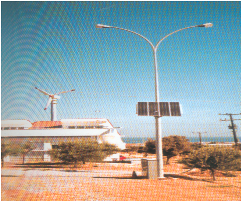
Σχήμα 10.2. Φ.Β. Εγκατάσταση για δημοτικό φωτισμό στο ΤΕΙ ΗΡΑΚΛΕΙΟΥ
