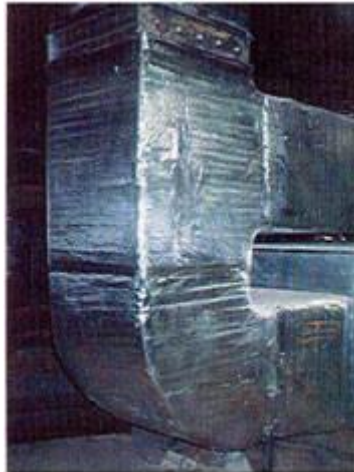
Σχήμα 23: Θερμομόνωση εγκαταστάσεων από πάπλωμα και με επικάλυψη αλουμινίου
