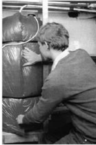
Σχήμα 22: Θερμομόνωση λεβητοστασίου με μονωτικές λουρίδες
