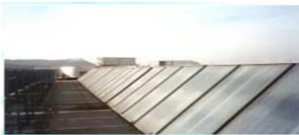
Σχήμα 29: Επιλεκτικοί επίπεδοι ηλιακοί συλλέκτες στην οροφή της γαλακτοκομικής επιχείρησης ΜΕΒΓΑΛ Α.Ε. για την θέρμανση νερού στο σύστημα CIP και για την προθέρμανση νερού στους ατμολέβητες
