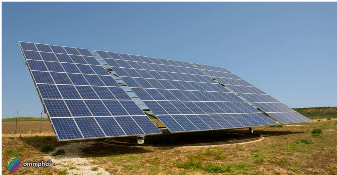
Εικόνα 1.4 Παραγωγή ηλεκτρικής ενέργειας από φωτοβολταϊκά
