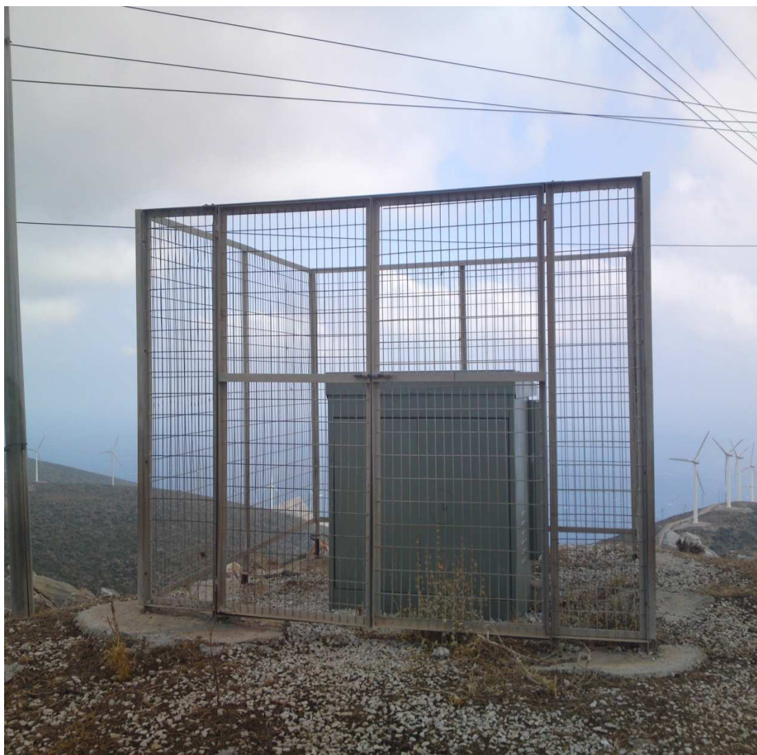
Φωτογραφία 4.1: Μετασχηματιστής ελαίου εξωτερικής χρήσης
