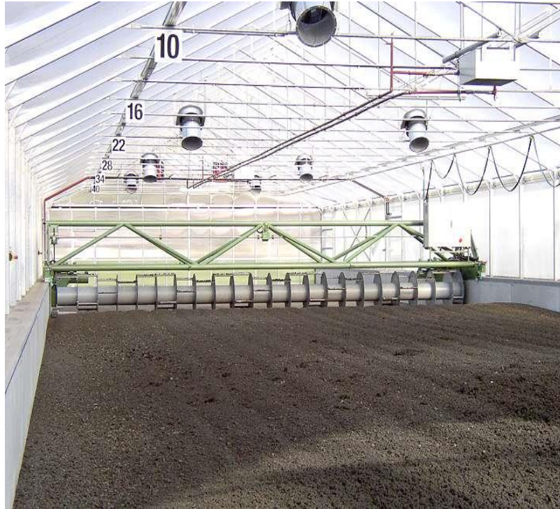
Εικόνα 2.2 «Μια εγκατάσταση με χρήση του συστήματος Wendewolf®»
