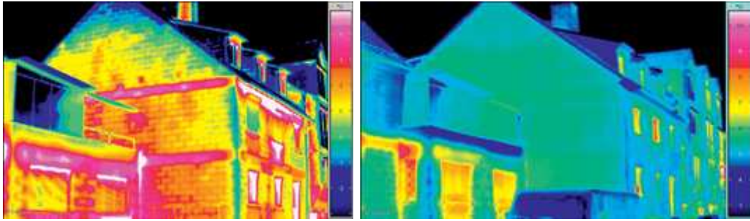
Εικόνα 2.3: Σύγκριση κτιρίων με εφαρμογή εξωτερικής θερμομόνωσης σε σχέση με κτίρια χωρίς εξωτερική θερμομόνωση (Πηγή: www.stathopoulos-s.gr και www.profilalouminio.gr )
