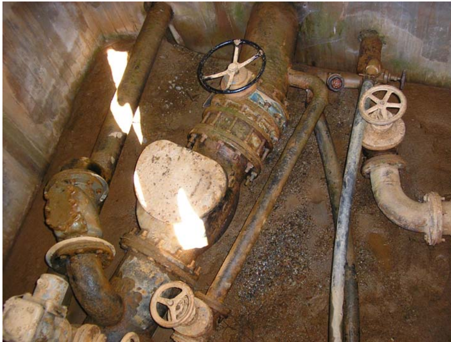
Εικόνα 3.6 Σωληνώσεις έξω από την δεξαμενή
