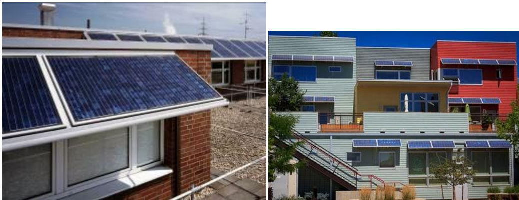
Εικόνα 3.30: Σκίαστρα με φωτοβολταϊκά πάνελ
