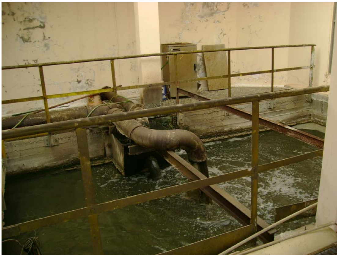
Εικόνα 7.3. : Σημείο έκχυσης βοθρολυμάτων στη δεξαμενή εξισορρόπησης, Μ.Ε.Υ.Α. της Δ.Ε.Υ.Α. Χανίων.
