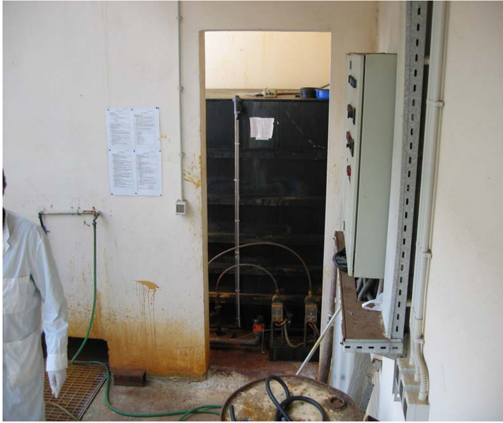
Εικόνα 6.1. : Δεξαμενή αποθήκευση του Ferrisol 140
