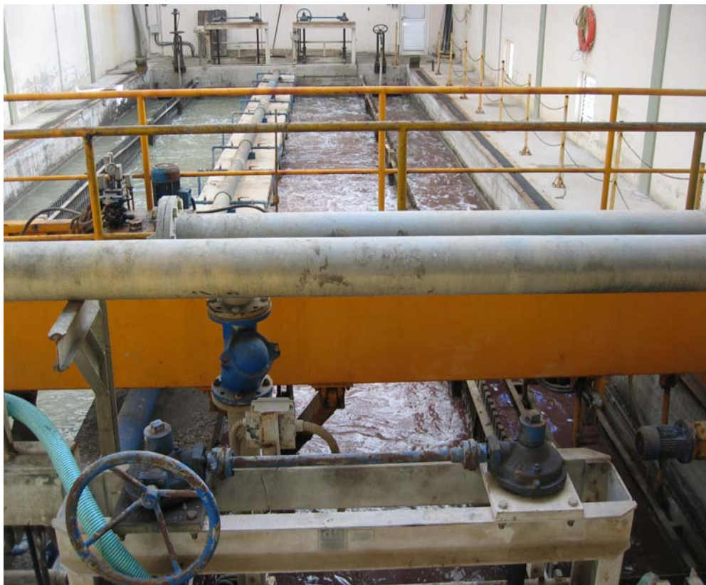
Εικόνα 6.2. : Σημείο προσθήκης του Ferrisol 140 πριν την δεξαμενή εξάμωσης.
