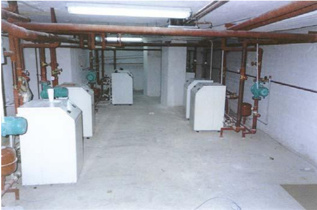
Εικόνα 2 : Γεωθερμική εφαρμογή στο Δημαρχείο Πυλαίας, Θεσσαλονίκη. Διακρίνονται οι αντλίες θερμότητας.
