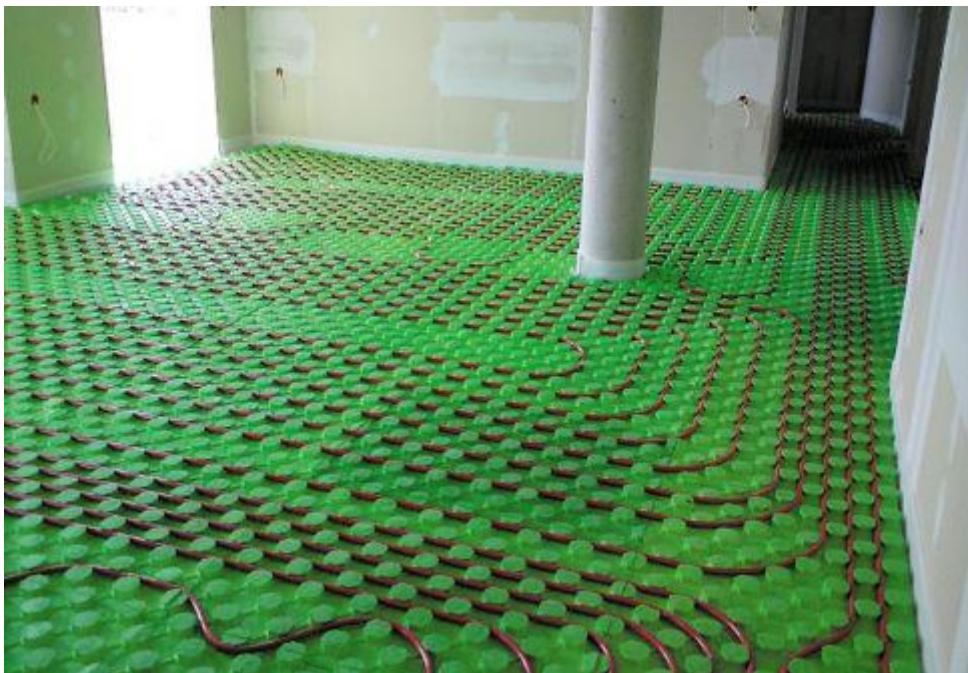
Εικόνα 17 : Με το ενδοδαπέδιο σύστημα μπορεί να θερμανθεί και να ψυχθεί όλο το σπίτι.
