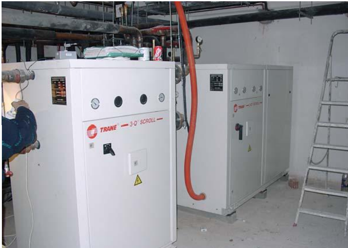
Εικόνα 4 : Γεωθερμική εφαρμογή στο Ευρωπαϊκό Κέντρο Δημοσίου Δικαίου, Λεγραινά Αττικής. Διακρίνονται οι αντλίες θερμότητας.
