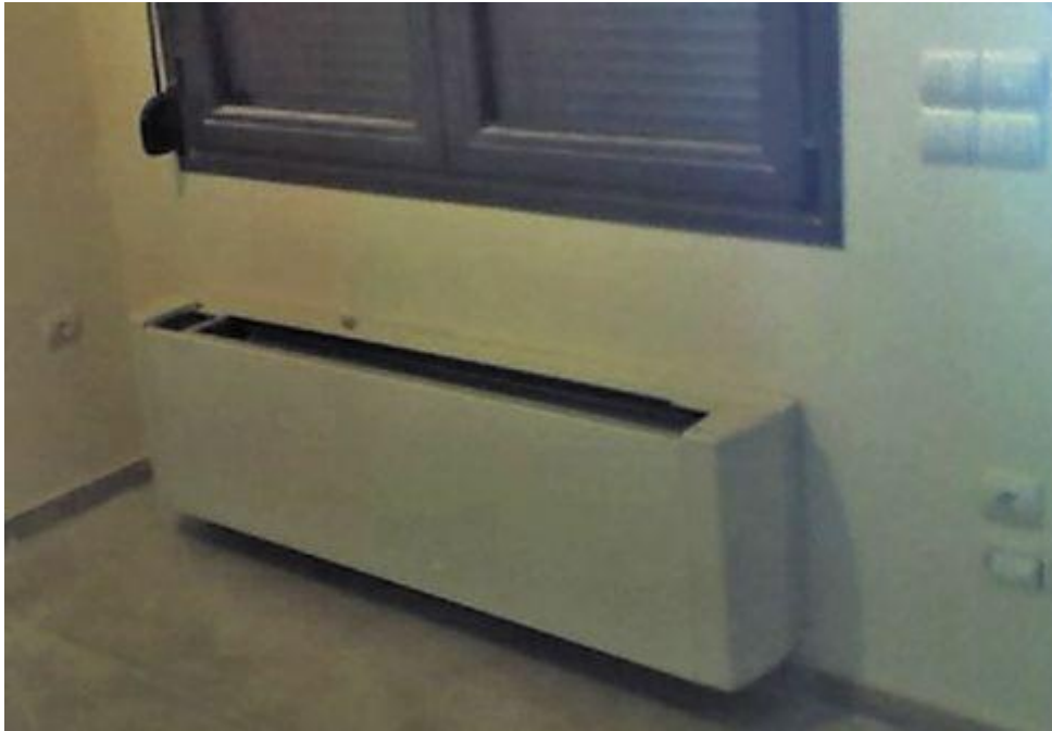
Εικόνα 16 : Μονάδες εξαναγκασμένης ανακυκλοφορίας αέρα [fan coil units].
