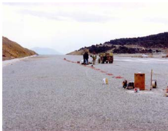
Γεωφυσικό συνεργείο του Τομέα Γεωφυσικής του Πανεπιστημίου Αθηνών σε εργασία προετοιμασίας της γραμμής του αναπτύγματος των γεωφώνων στη πίστα του διαδρόμου προσαπογείωσης του αεροδρομίου της Ικαρίας στα πλαίσια σεισμικής έρευνας διάθλασης για την επέκταση του αεροδιαδρόμου (ΙΓΜΕ, 1996)
