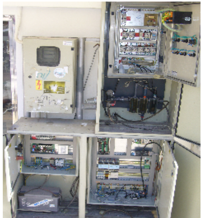
Εικόνα 11. Εξοπλισμός σταθμού διαρροών
