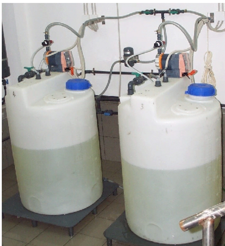
Εικόνα 7. Δοχεία και αντλίες χλωρίωσης
