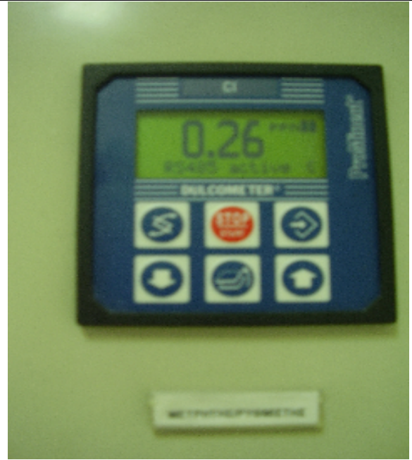
Εικόνα 87. Ελεγκτής PID αντλιών χλωρίωσης αγωγού Φ350 Αγυιάς
