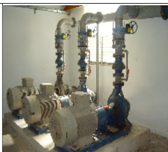
Εικόνα 30. Βοηθητικές αντλίες αντλιοστασίου Αγιάς
