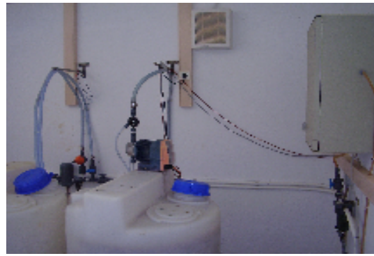
Εικόνα 82. Συγκρότημα χλωρίωσης αγωγού Φ350 στην Αγιά
