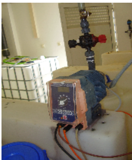
Εικόνα 83. Συγκρότημα χλωρίωσης Αγωγού Φ350 στην Αγιά, δοσομετρική αντλία χλωρίωσης
