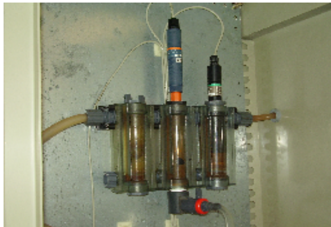
Εικόνα 85. Αισθητήρια μέτρησης HOCL, PH, T στον αγωγό Φ350 στην Αγιά.
