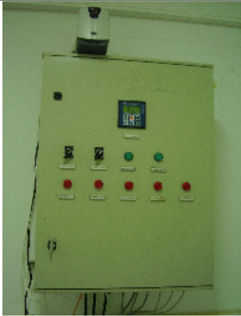
Εικόνα86. Ηλεκτρικός πίνακας μέτρησης ελεύθερου υπολειμματικού χλωρίου και ελέγχου αντλιών χλωρίωσης του αγωγού Φ350 στην Αγυιά.
