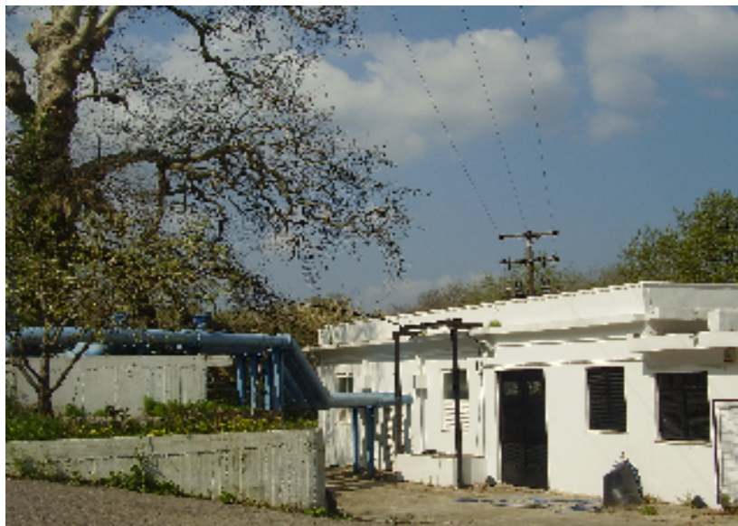
Εικόνα 28. Κτίριο μέσης τάσης στην Αγιά.(Εξωτερικά).
