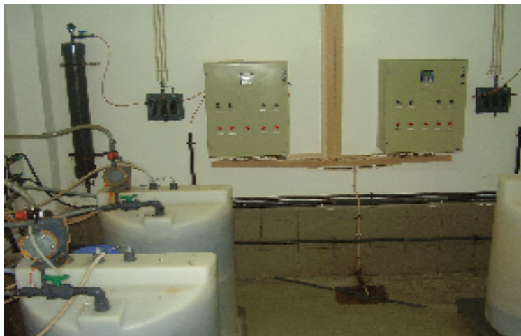
Εικόνα 88. Συγκροτήματα προχλωρίωσης και μεταχλωρίωσης δεξ. Βαντέ
