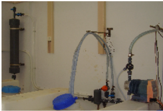
Εικόνα 81. Συγκρότημα χλωρίωσης αγωγού Φ350 στην Αγιά
