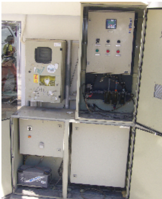
Εικόνα 10. Εξοπλισμός σταθμού διαρροών
