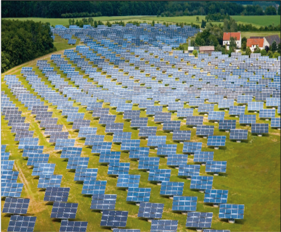
Εικόνα 3.6: Φ/Β εγκατάσταση με trackers στην Γερμανία
