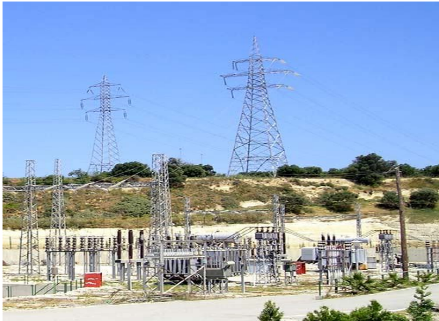
Εικόνα 6: Υποσταθμός στο Ηράκλειο (περιοχή Πανεπιστημίου)
