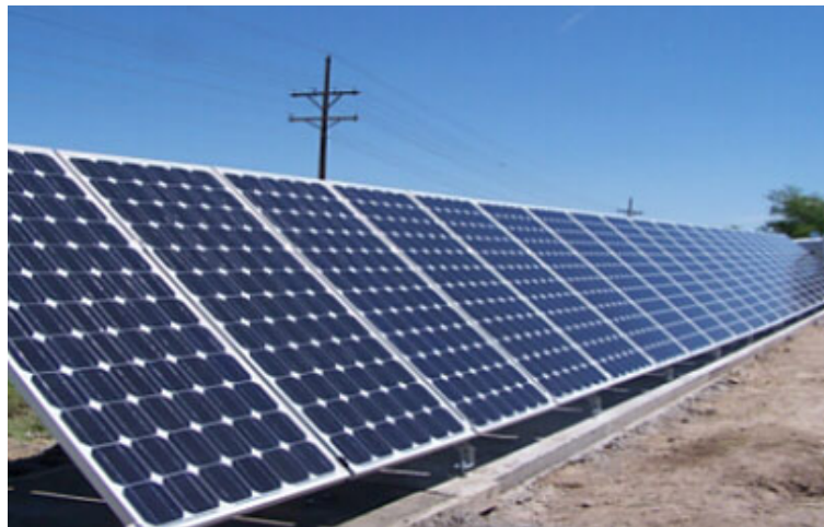
Εικόνα 4.2.1: Σύστημα Φωτοβολταϊκών πλαισίων
