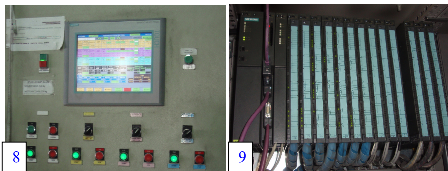
6.4.6 Πίνακας ελέγχου με Simatic Panel και το PLC S 400
