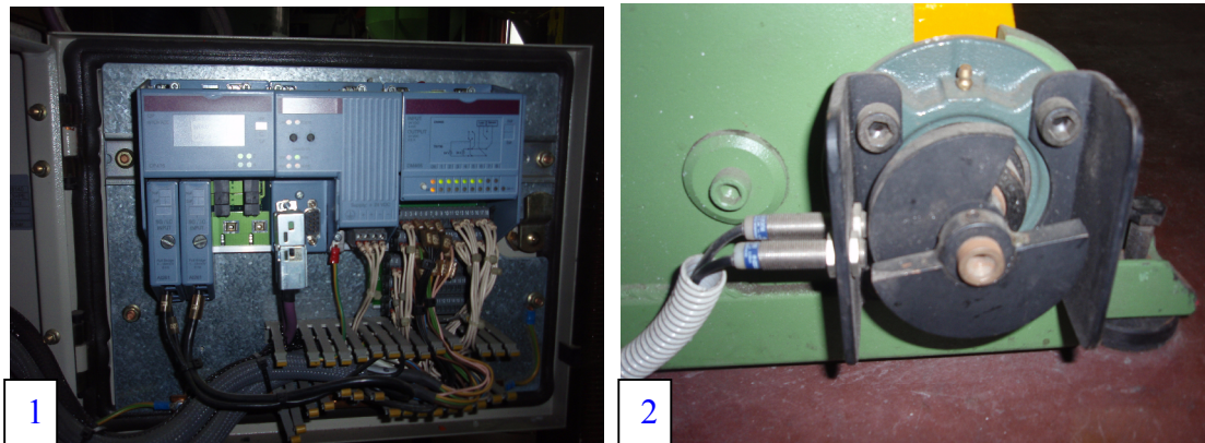
6.5.1 Το PLC BnR και δύο επαγωγικοί διακόπτες ελέγχουν την μηχανή τυλίγματος.
