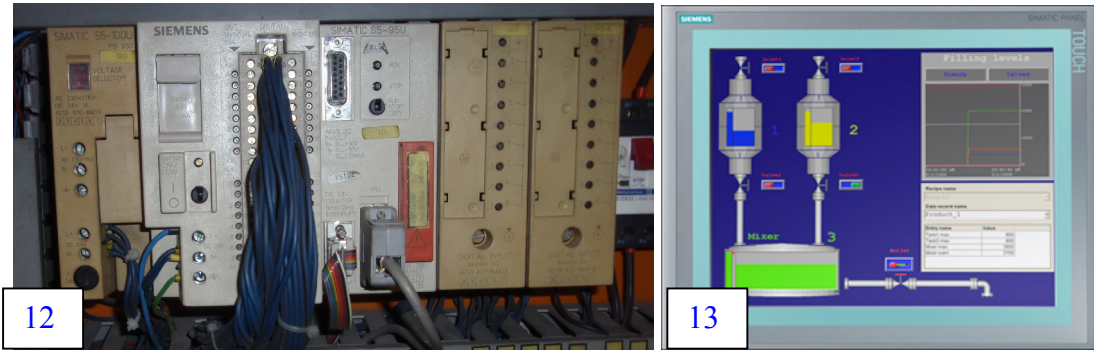
6.4.8 Το PLC της Siemens, σειράς S5 και Siemens touch panel.
