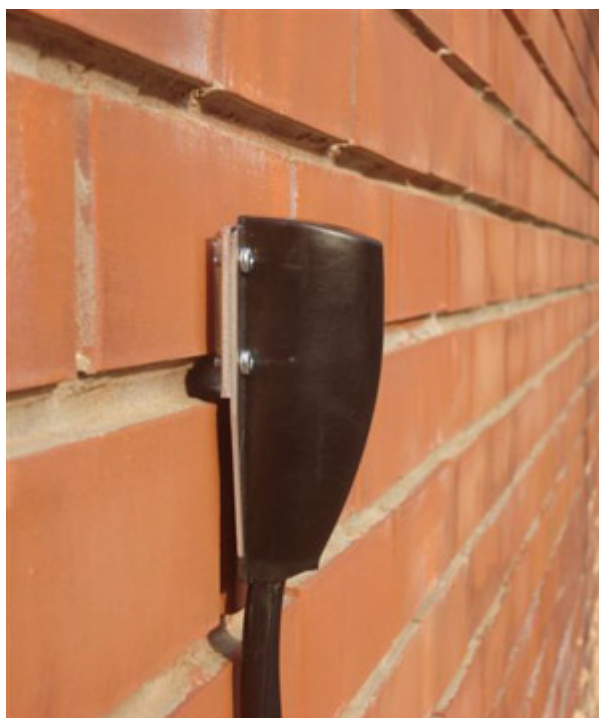
Εικόνα 256: Αισθητήρας δόνησης τοίχου
