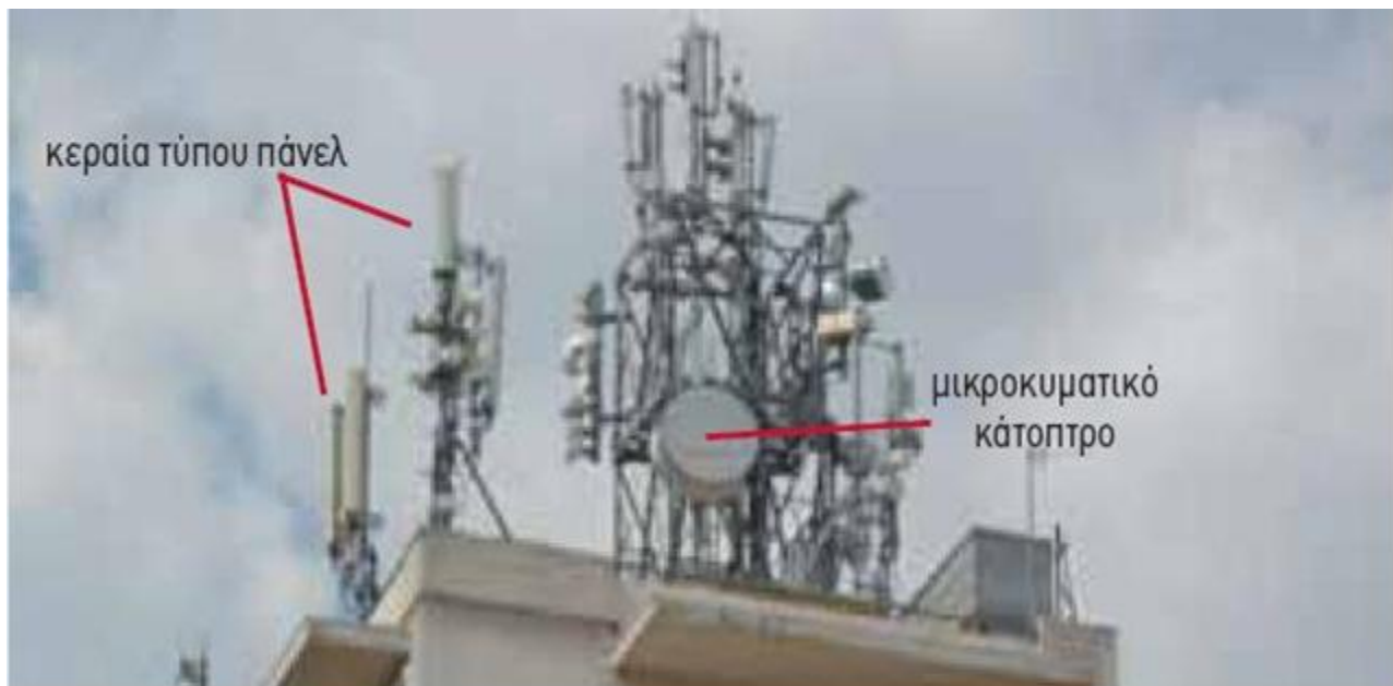
Φωτογραφία 1: Χαρακτηριστική φωτογραφία σταθμού βάσης κινητής τηλεφωνίας
