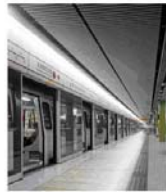
a. Automatic door system
