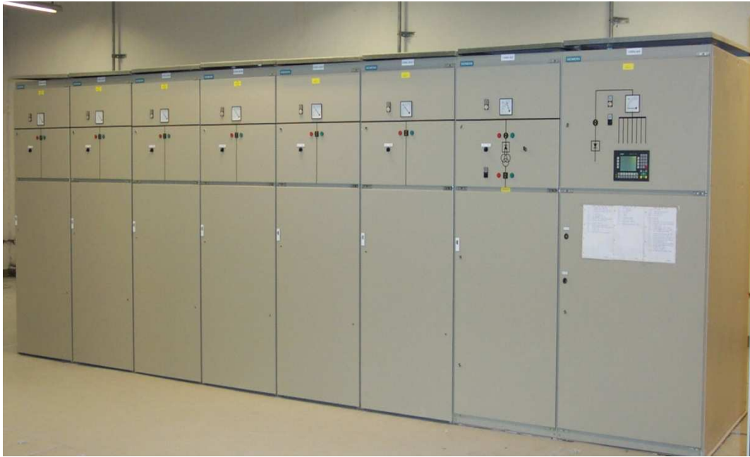
Φωτ. 4 Πίνακας Συνεχούς Ρεύματος
