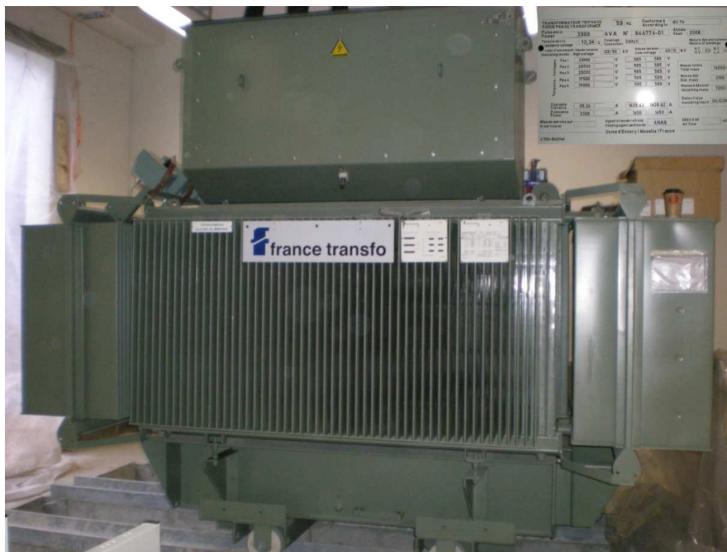
Φωτ. 2 Μετασχηματιστής Ανόρθωσης
