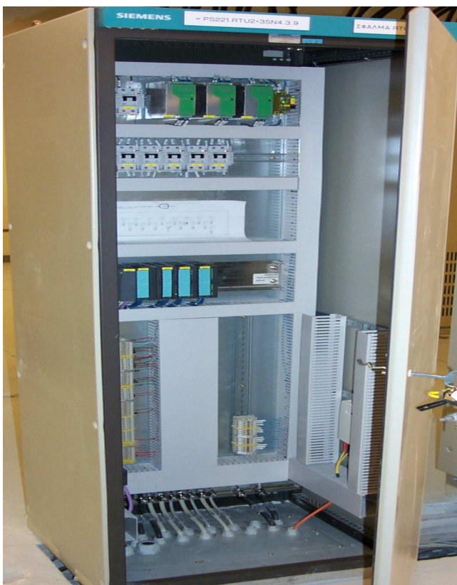
Φωτ. 5 Μονάδα RTU
