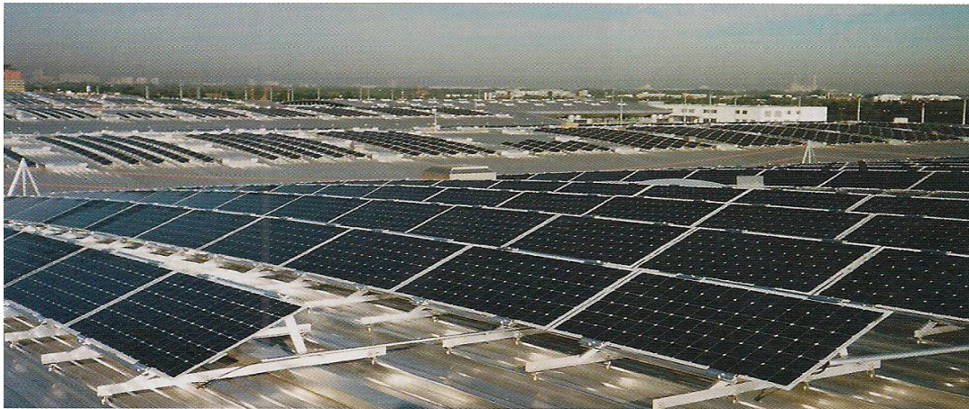
Σχήμα 5.2.1.7: ΦΒ σύστημα 1MW στο Εκθεσιακό κέντρο Neue Messe, Μόναχο, Γερμανία.
