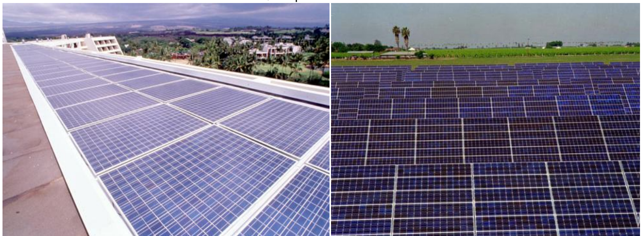
Εικόνες 1.6.16: Φωτοβολταϊκή ηλεκτρική ενέργεια
