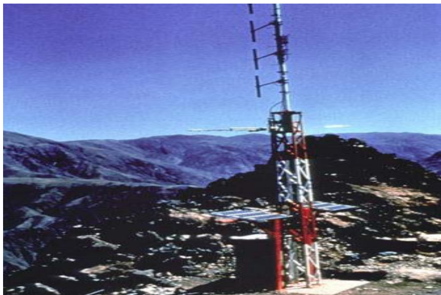
Εικόνα 4.3.1.4: Τηλεπικοινωνίες και φωτοβολταϊκές βαθμίδες άρρηκτα συνδεδεμένες υπό ακραίες συνθήκες.
