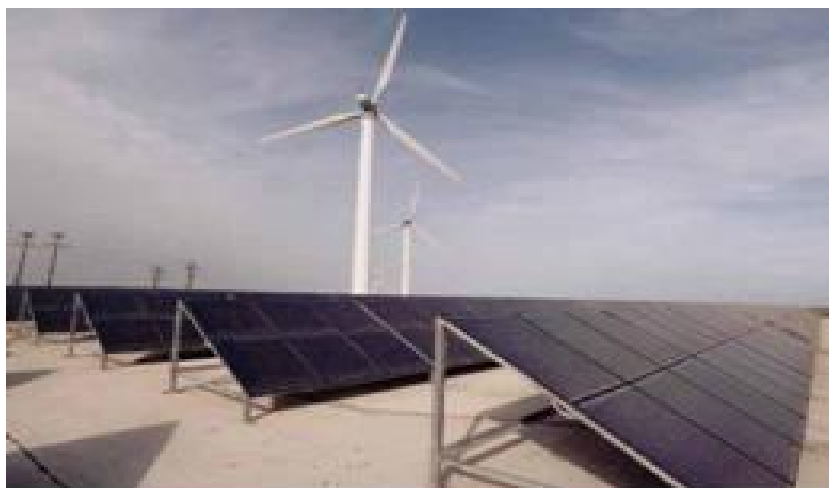
Εικόνα 2.5.3.1.42: Φωτοβολταϊκά πλαίσια τοποθετημένα με σταθερή γωνία κλίσης
