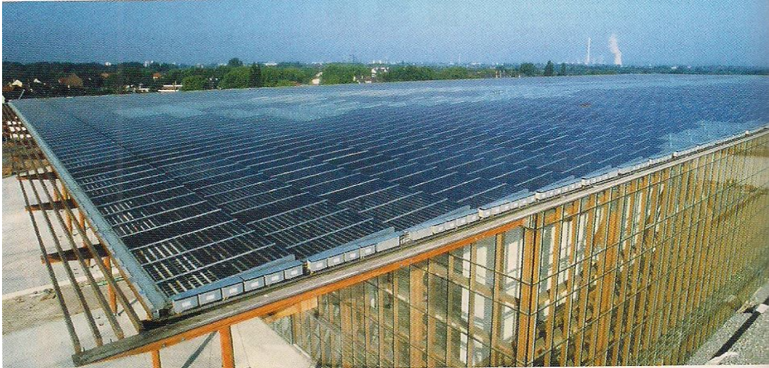
Σχήμα 5.2.2.9: Μετατροπείς σε γραμμή χρησιμοποιούνται σε ΦΒ συστήματα 1MW, στην ακαδημία εκπαίδευσης Mont Ceris, στο Herne της Γερμανίας.
