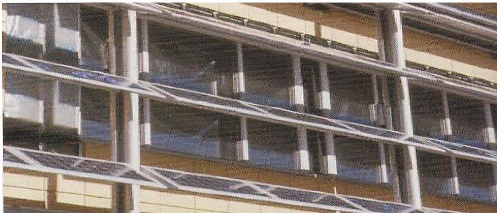
Σχήμα 5.2.3.13: ΦΒ πρόσοψη με μετατροπείς σε σειρά, του κτηρίου ECN στις Κάτω Χώρες. Πηγή: OJA-Services, Copyright: Tjerk Reijenga
