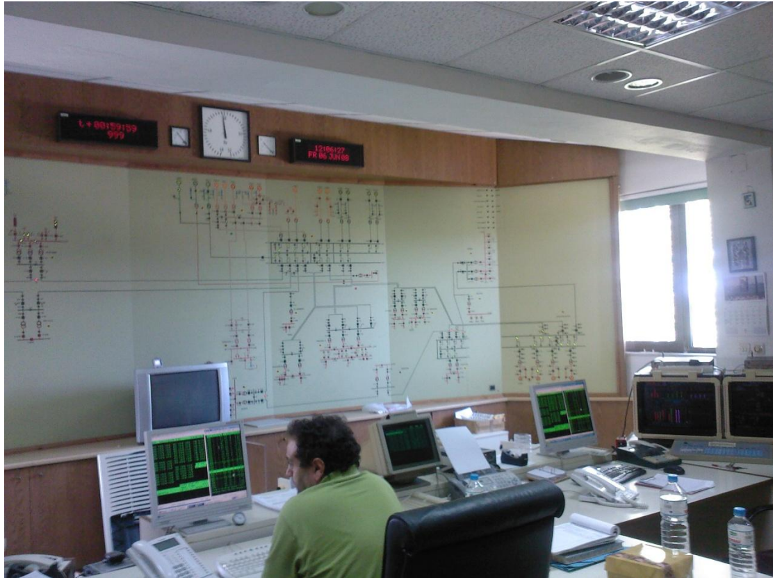
Εικόνα 3.1: Απεικόνιση ΚΚΦΚ στον Κατσαμπά Ηρακλείου, είναι εμφανές το SCADA που εποπτεύει ολόκληρο το δίκτυο αλλά και ο χειριστής βάρδιας.
