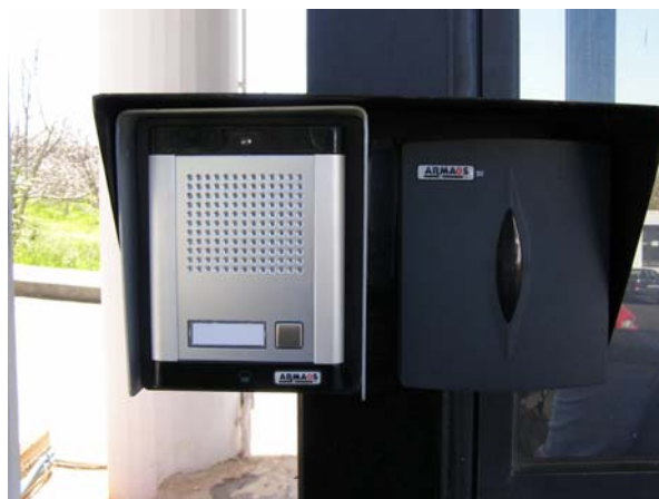
Εικόνα 5.1 Access control και κουδούνι
