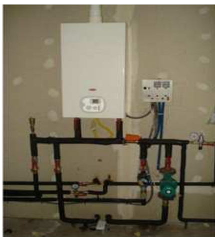
Εικόνα 6: Αυτόνομος επιτοίχιος λέβητας υγραερίου.
