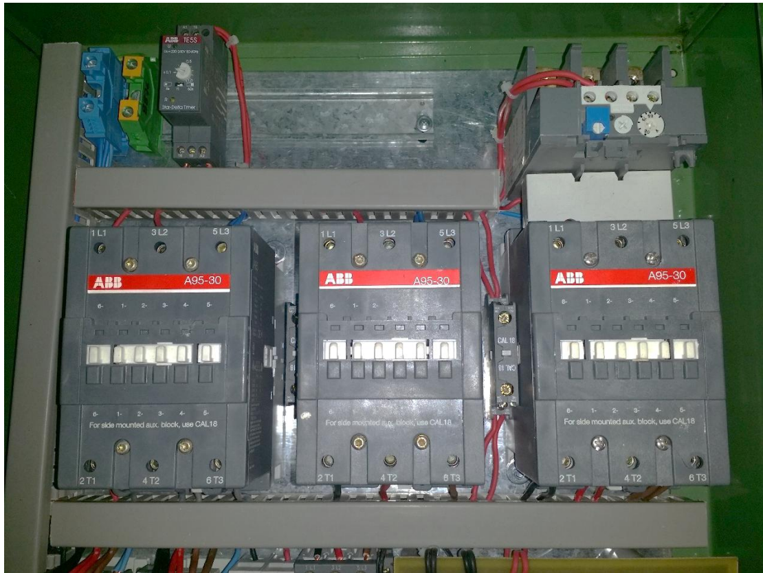
Εικόνα Ρελέ αυτοματισμού αστέρα - τρίγωνο
