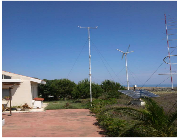
Ιστός μετεωρολογικού σταθμού Κρήτης
