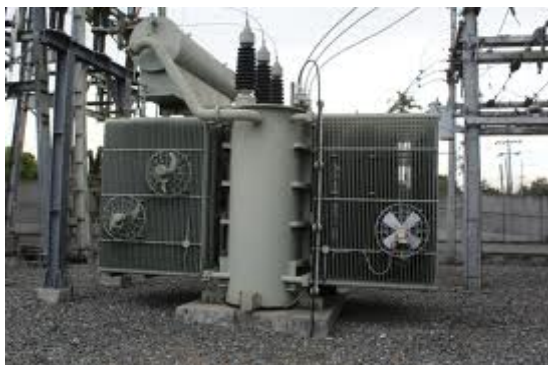
Εικ. 1.2. Μετασχηματιστής ελαίου με δοχείο διαστολής και ανεμιστήρες για την ψύξη του, σε εξωτερικό χώρο.
